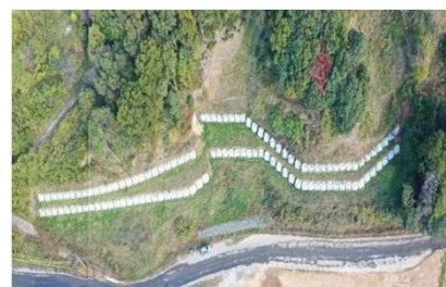
朝倉市道の上部において治山事業による復旧工事が完成。(福岡県朝倉市)
