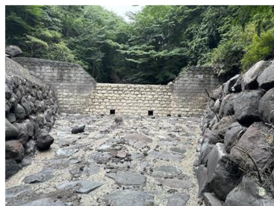
③ 既設治山ダムの状況 土砂が治山ダムの袖を越流した状況を確認
