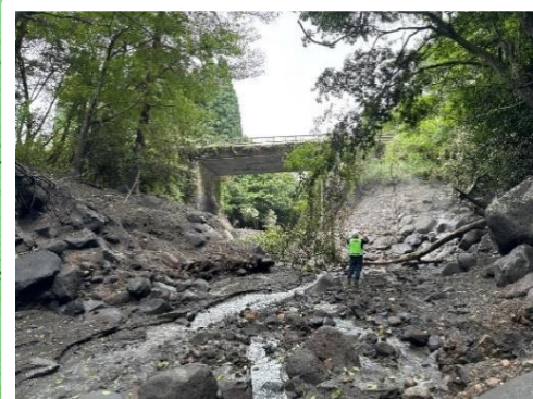
④ 永池二号橋の状況 土砂が永池二号橋を流下したことを確認
