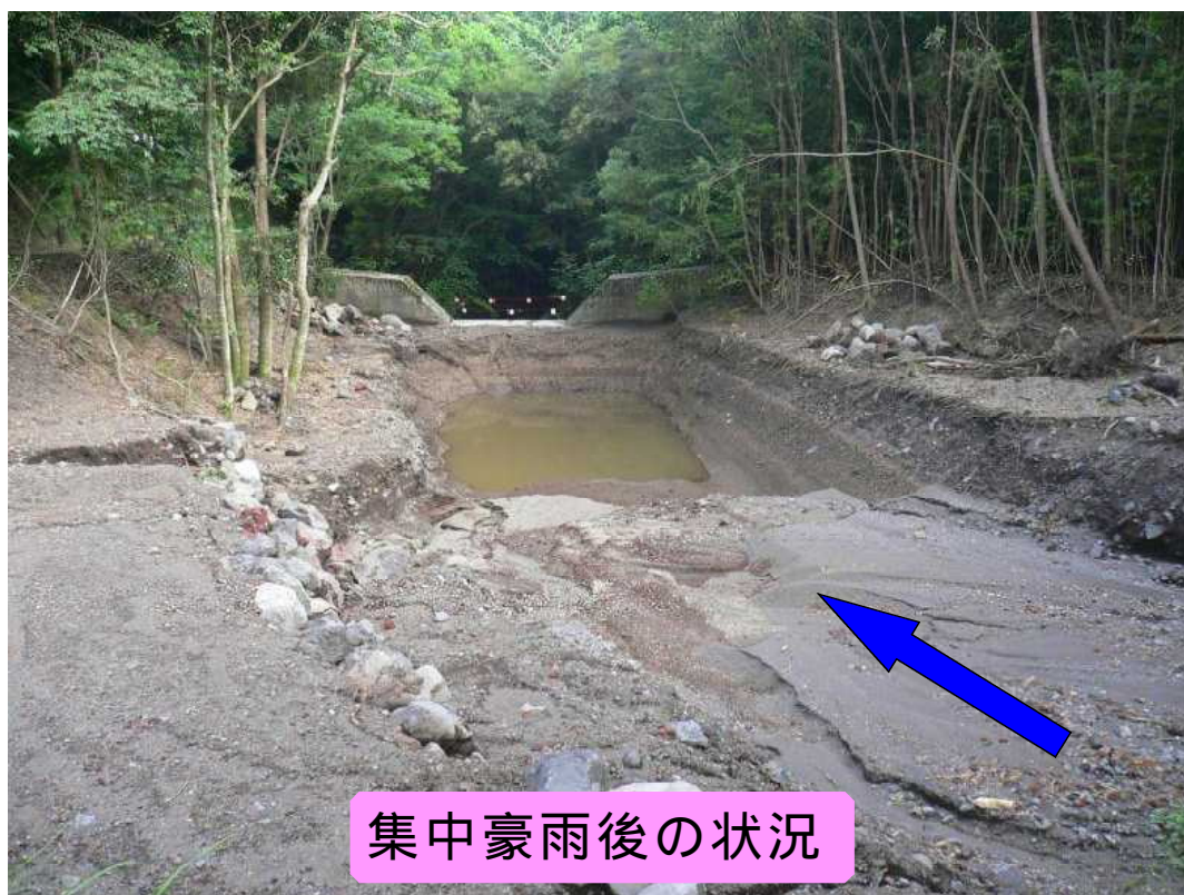
流出した土砂を捕促した状況
