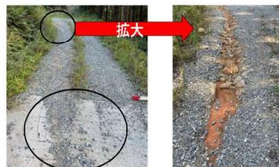
図4 クラッシャーランの洗掘状況
