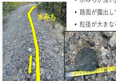
図5 山ずりの洗掘状況
