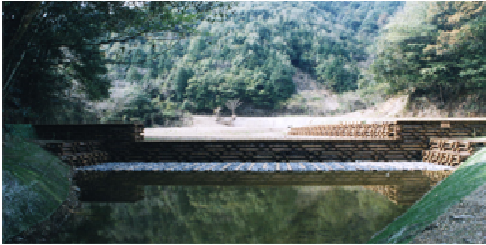
木製床固工及び木製沈床工・木製護岸工 (都城支署管内)
