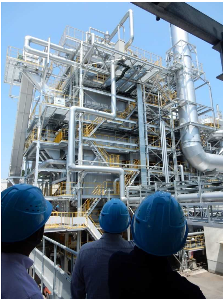
蒸気発生設備
