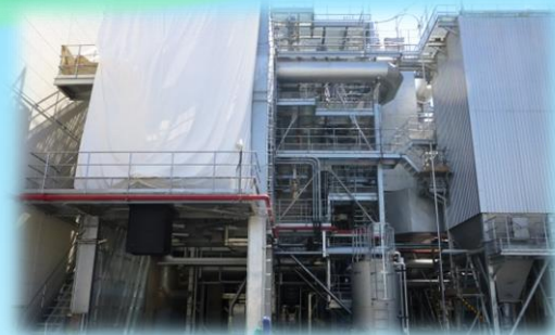
バイオマス発電所
