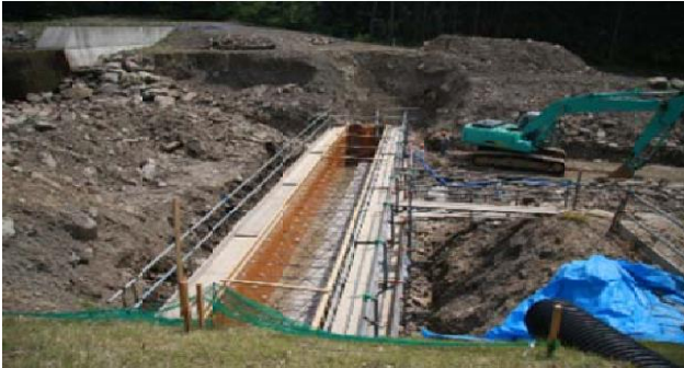
上：合板型枠の構成 中：合板型枠の組み立て状況 下：合板型枠の組み立て完了
