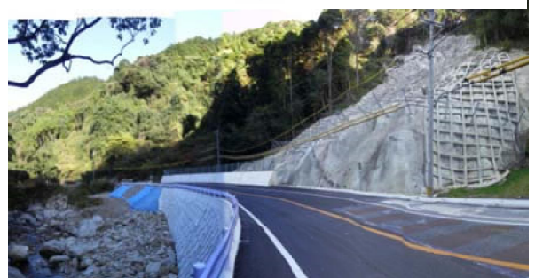
平成21年7月、集中豪雨により被災した国道385号線の被災直後（写真：上）。当被災地は、福岡県と連携し平成22年3月には復旧（写真：下）
