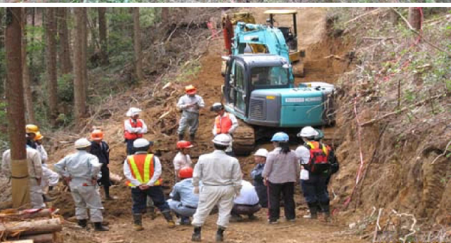
(上) 簡易で崩れにくい作業路で間伐材の搬出作業状況 (中) 作業路を活用し列状間伐を完了の林内の状況 (下) 路網・作業システムについて検討する皆さん
