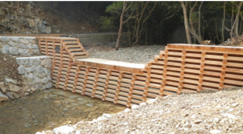
木材や現地で発生した土石を活用した治山施設＝木製床固工（長崎県五島市）
