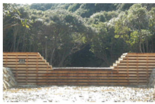
木材を利用した治山ダム
