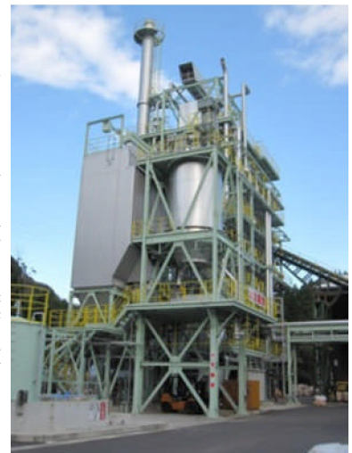
木質バイオマス発電所
