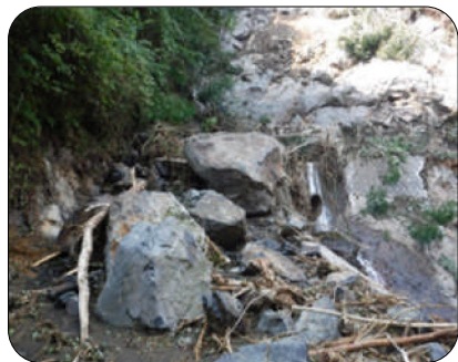
大雨による林道の被害
