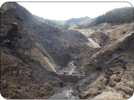
治山施設被害：南阿蘇村内早川
