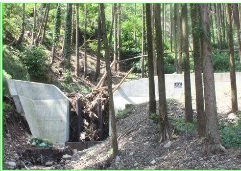
谷止工の流木補足状況（鹿児島県志布志市）
