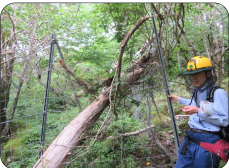
白鳥山 植生保護柵の破損状況
