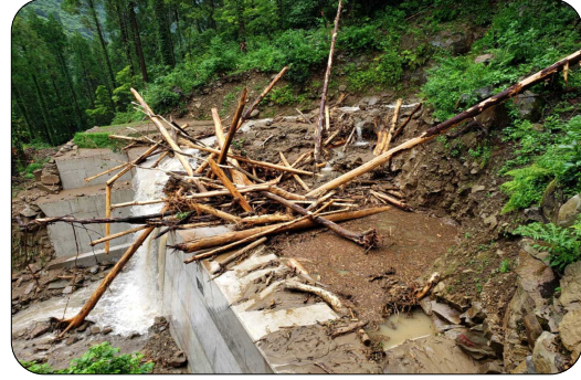
谷止工の流木補足状況（宮崎県串間市）
