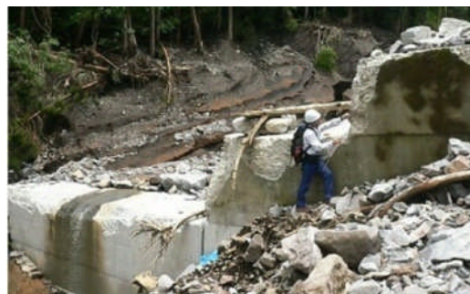
破壊された谷止＝黒川本流
