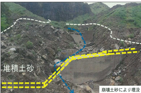
東小堀B地区：被災後の治山ダム
