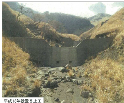
東小堀B地区：被災前の治山ダム
