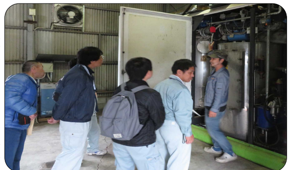
小型バイオマス発電施設の視察((株)ハマテック)
