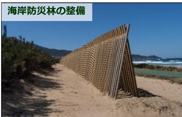
津波の減勢や塩害・飛砂等の軽減のため、海岸防災林の整備を進めています。(岡垣町：福岡署)
