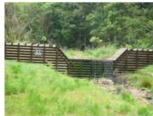
景観に配慮した治山ダム (五島竜岐)
