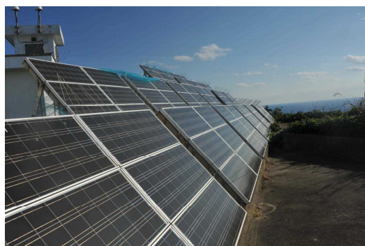
写真4 太陽光発電設備
