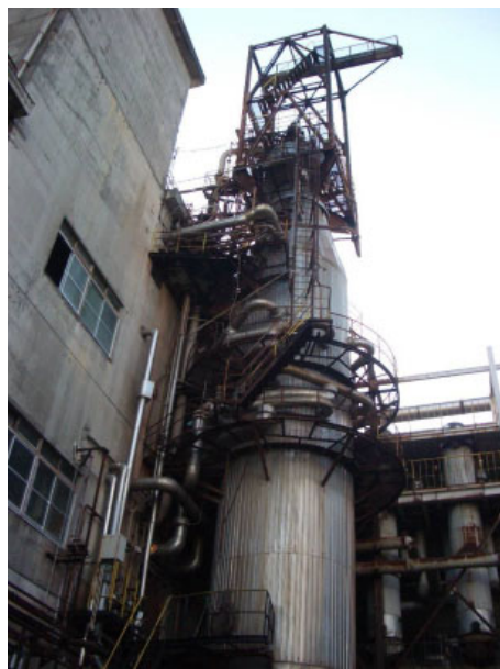
間伐材パルプをつくる小型の蒸解釜
