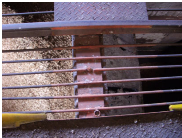
間伐材チップサイロ(上部から見た区画の切れ目)
