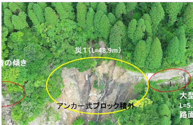
地すべり発生箇所
