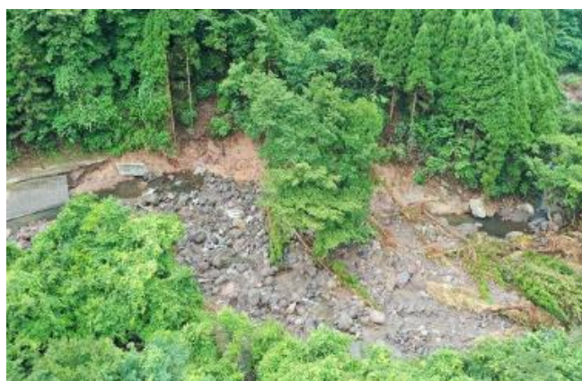
林道の崩壊地（ドローン撮影）
