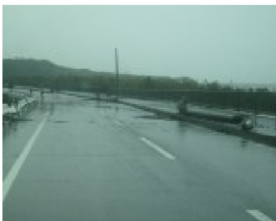
台風による被害（電柱の倒壊現場）
