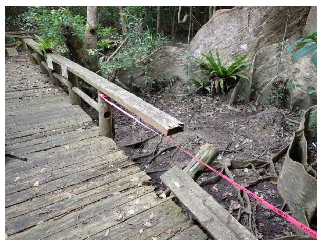
【写真13 展望デッキ破損状況】
