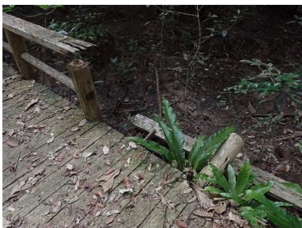
【写真12 破損した木道】
