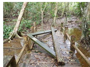
【写真15 壊れた手摺り等】
