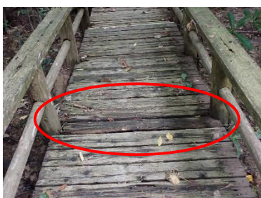
【写真13 腐朽が著しい連絡道床板】
