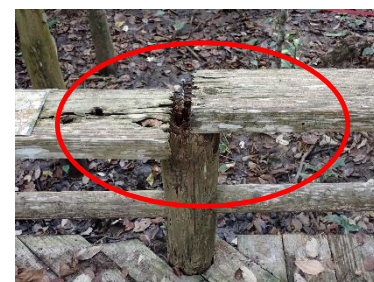
【写真14 接合部分が腐朽した手摺り】
