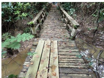
【写真 9 腐朽が著しい連絡道】
