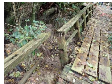
【写真 10 連絡道の手摺り （機能していない）】
