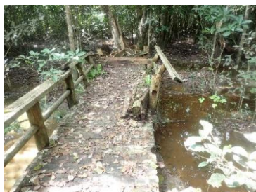
【写真 11 台風被害により壊れた手 摺り等 (BM1 付近)】
