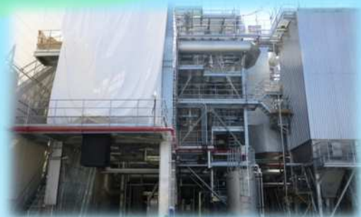
バイオマス発電所
