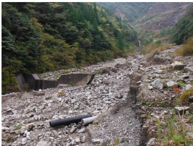
治山施設の復旧（施工前）
