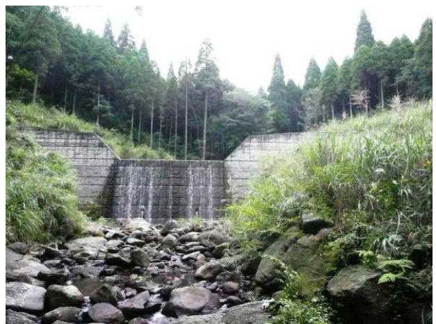
⑪治山施設：谷止（日添国有林）
