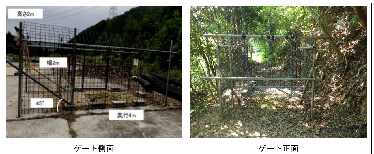
図7 潜り込み式ゲート設置状況
