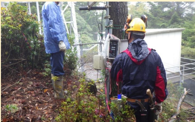
親機点検状況
