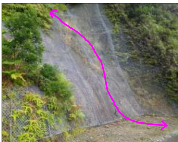
写真 2-11-19 シカが昇り降りに利用している県道白谷線の山側法面の崩落防止ネット
