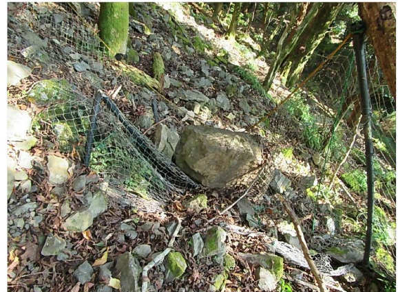
写真 2-5-2-6 大森岳 2049 状況：土砂の堆積と転石による破損
