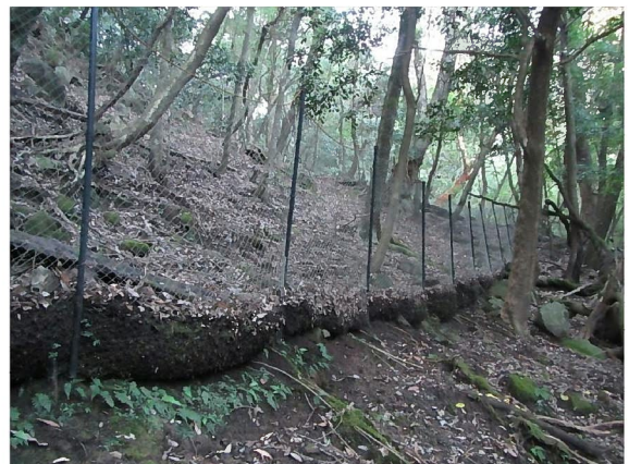
写真 2-5-2-8 小池 状況：土砂の堆積
