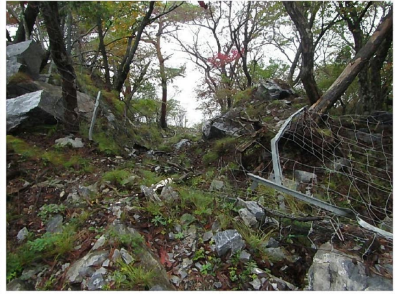
写真 2-5-2-2 洞岳 状況：転石による破損
