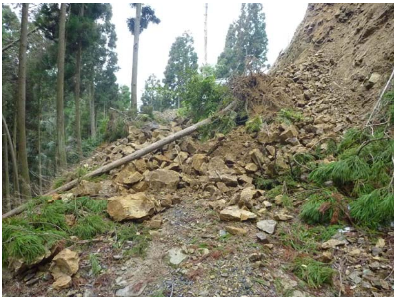
写真 2-3-2-2 法面崩壊の状況（大越 111 作業道）
