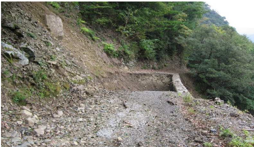
写真 2-3-1-10 林道路盤の流出箇所（ゲートより約 7km 地点）
