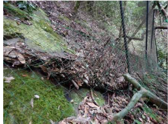
写真 2-3-2-4 大森岳 2092 A 柵 状況：土砂の堆積
