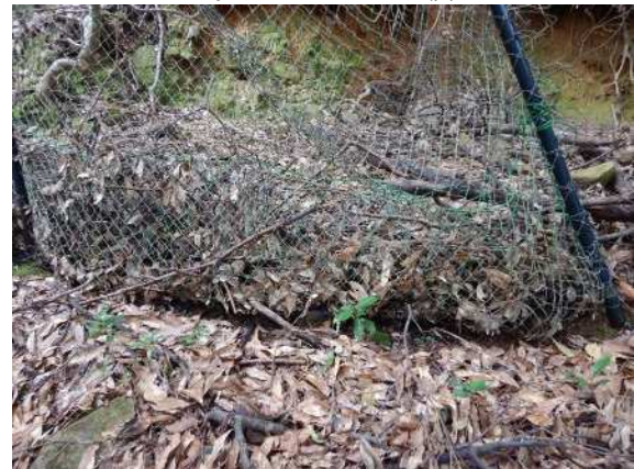
写真 2-3-2-6 大森岳 2092 B 柵 状況：土砂の堆積
