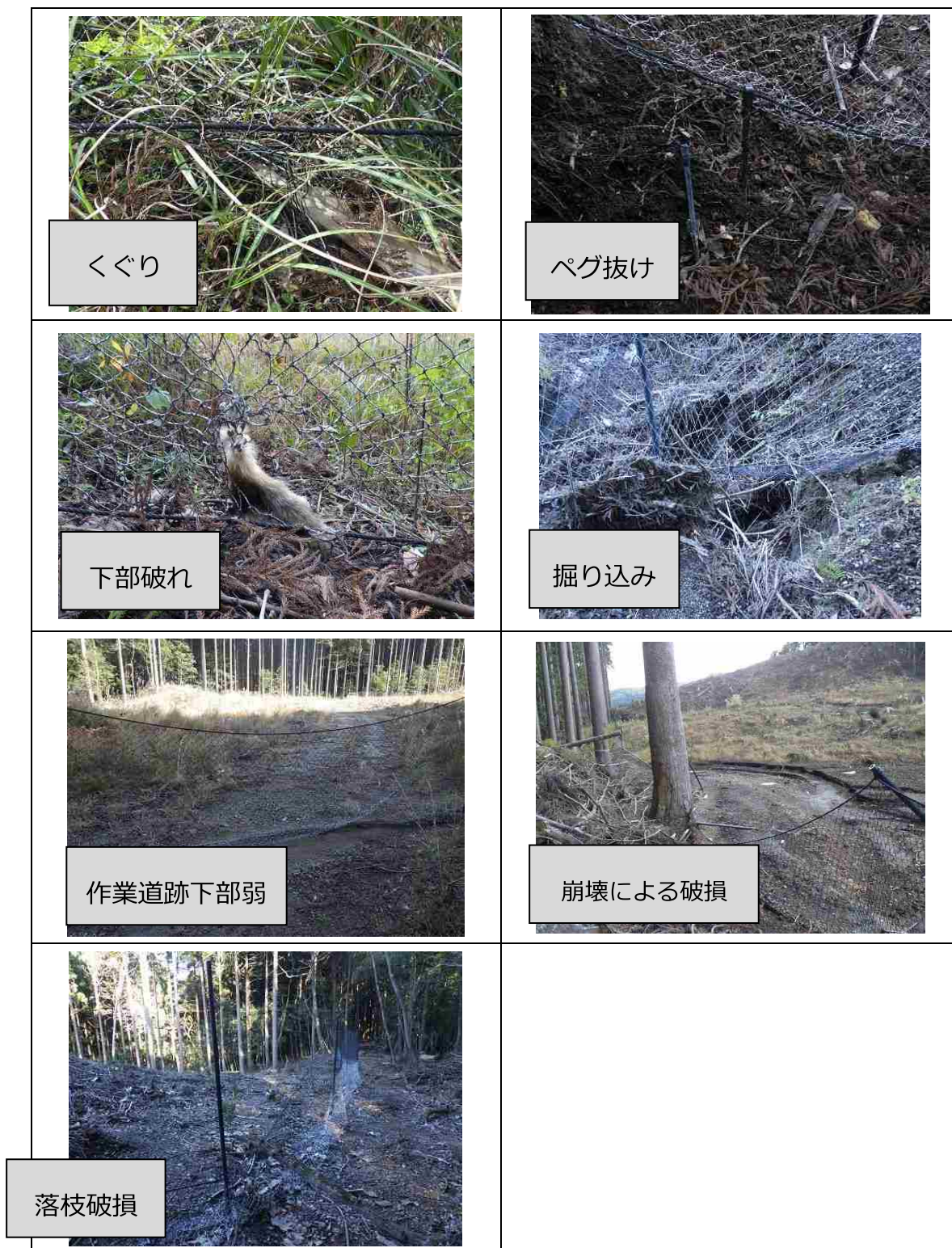
写真 2.3.8 各破損等の状況
