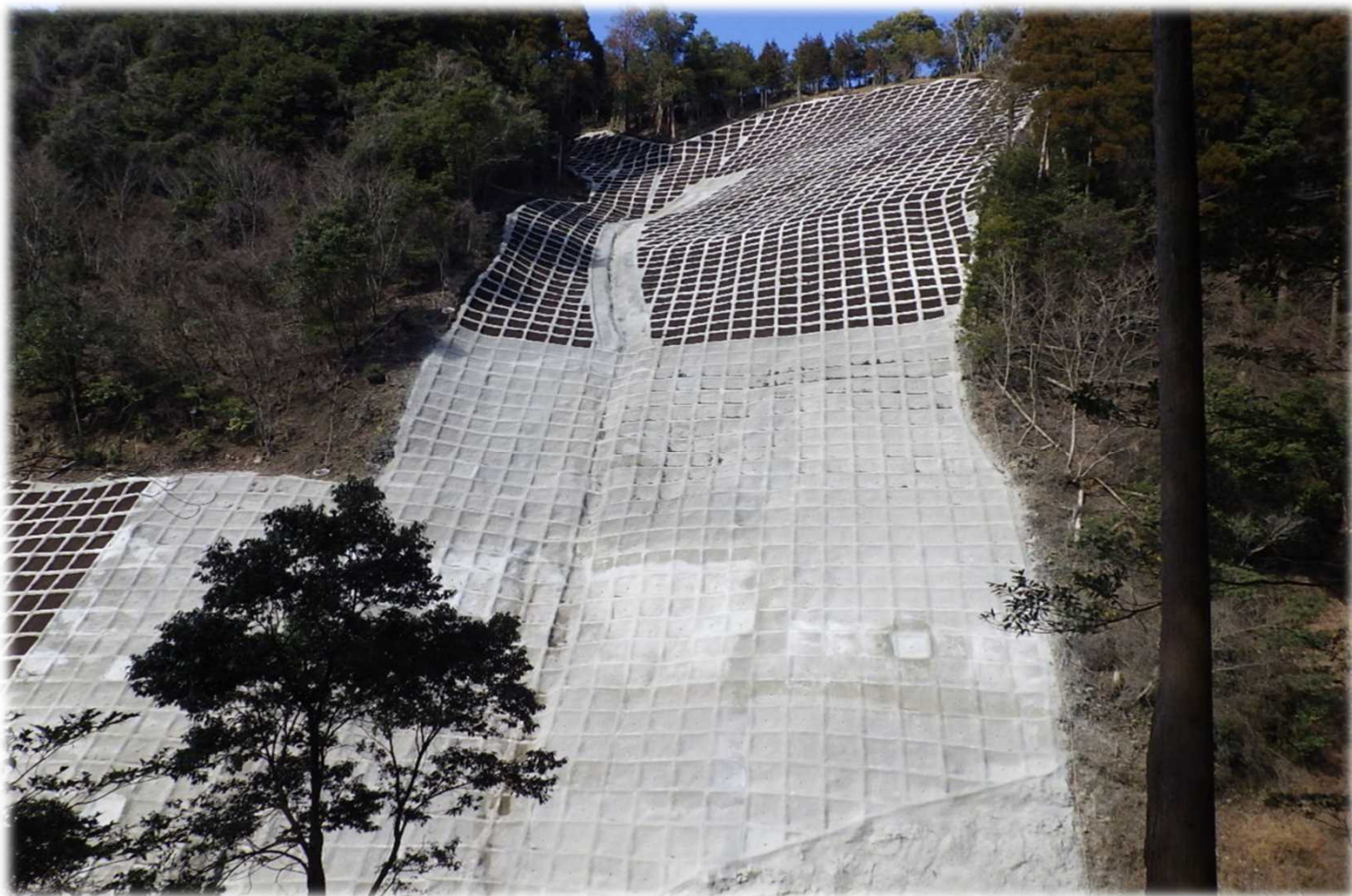
大雨により被災した山腹斜面を復旧（田の口国有林 朝倉市）
