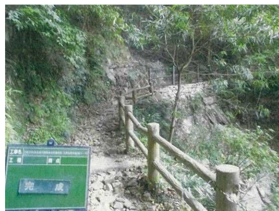
転落防止のための柵
