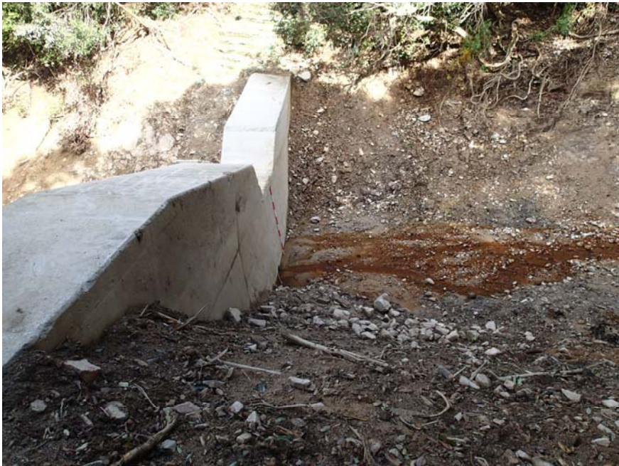
写真 4.1.1 既設谷止工背面状況（未満砂高 2m）
