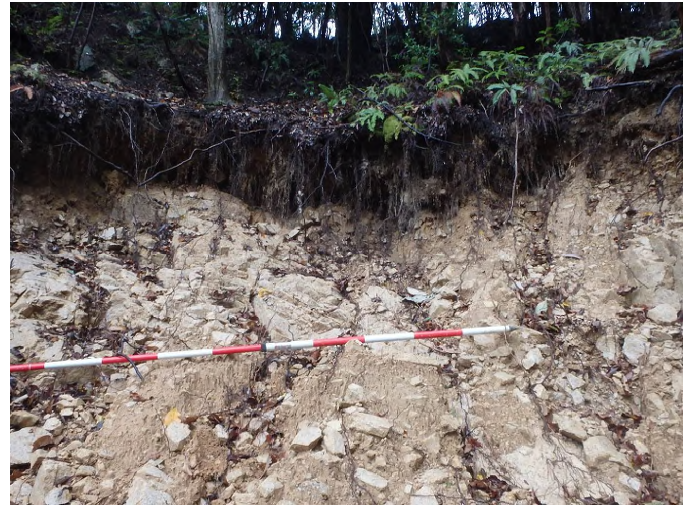
写真 3.1.2-C 高松山 6 号地 (ホ-15) 崩壊源滑落崖の状況 崩壊面には割れ目に富んだ花崗岩が露出、その上部を岩屑堆積物、表土が覆う。
