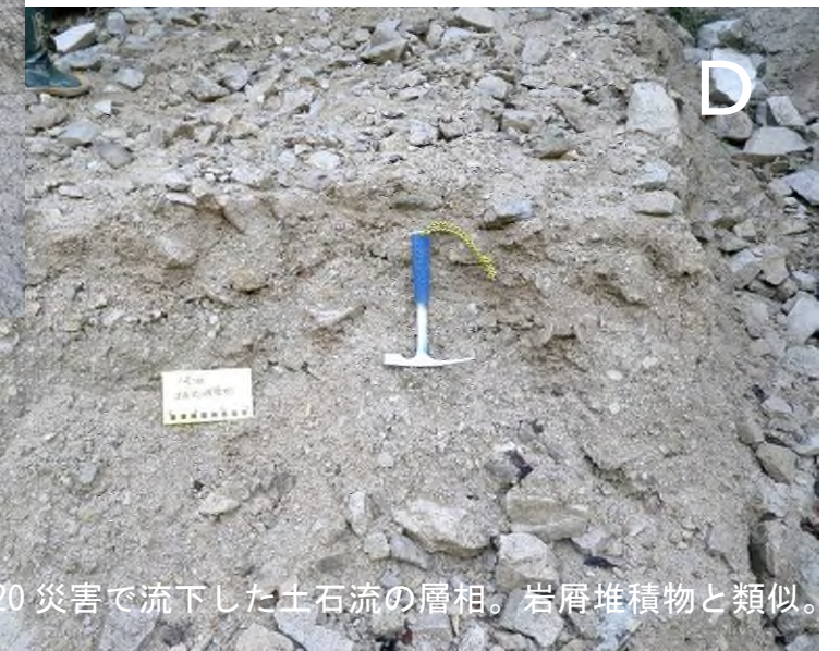
土石流の洗掘で露出した岩屑堆積物/基盤境界
