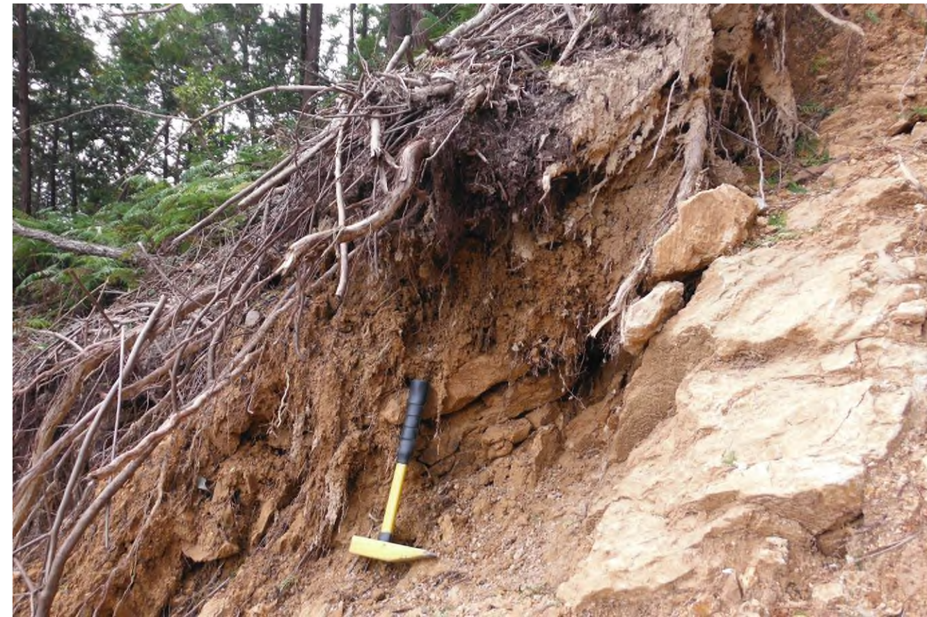
写真 3.1.2-B 高松山 7 号地 (ケ-7) 崩壊源 b 崩壊源滑落崖の状況 滑落崖の断面には、表層堆積物の下位に岩屑~開口割れ目に富む緩んだ花崗岩が露出している。
