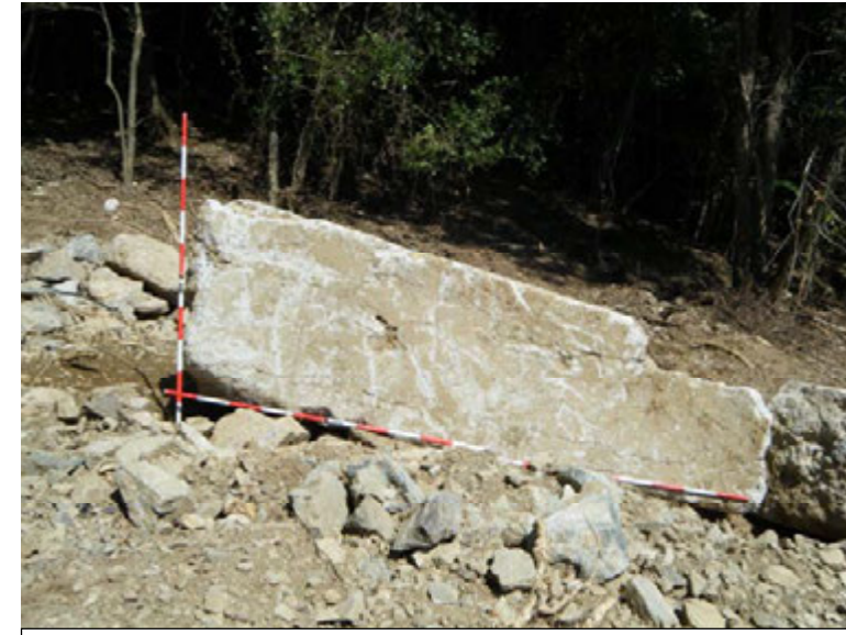
写真③ 流失コンクリート片 (1.2m×4.0m×1.0m) (写真撮影日 2014年10月8日)
