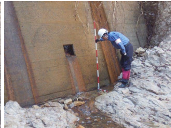
写真 8.2.2 下流つま先の小規模な洗掘
