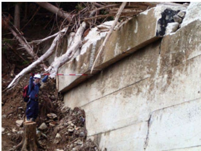
写真② 水平打継目部 段差最大 40cm
