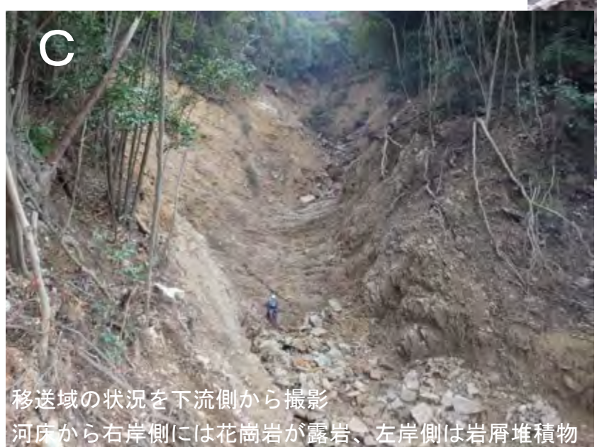
溪床崩壊状況を上流側から撮影
