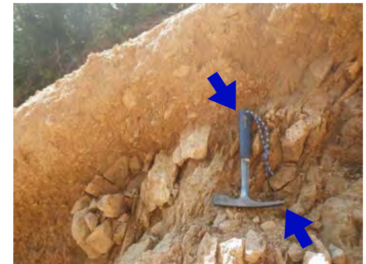
⑩基盤上部の割れ目の開口した高透水ゾーン 基盤岩の露岩する崩壊源で多くみられる
