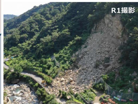
▲【R1.7被災の斜面崩壊地】 （上秋津区域）
