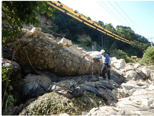
破損した落石防護柵
