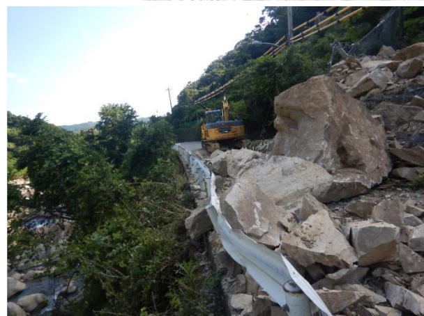
ガードレールに達した落石
