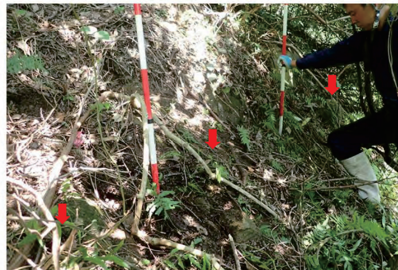
③今回崩壊に伴い発生した滑落崖（クラック）：60cmの深さまでポールが貫入。
