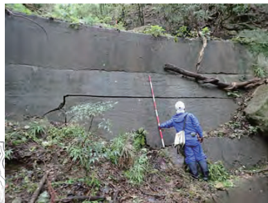
P.2 コンクリート擁壁（水平方向クラック）
