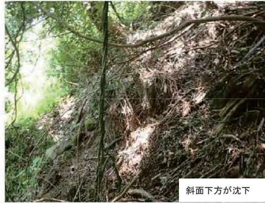
斜面下方が沈下
