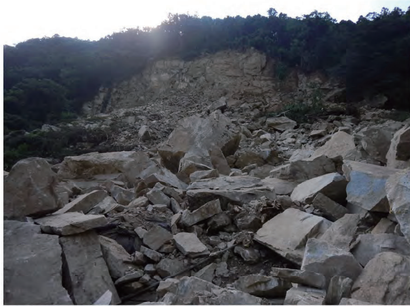
④崩壊箇所近景：崩壊土砂は砂岩主体の角状礫及び巨石から構成される。
