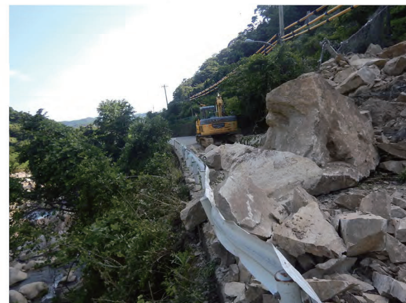
⑦ガードレールを破損した崩壊土砂：タンポバリアーにより減勢されたため2級河川右会津川には到達しなかった。
