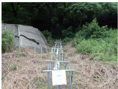
P.1 頭部滑落崖に設置した伸縮計
