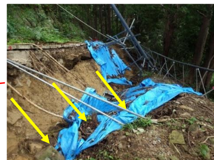
亀裂が進行した滑落崖
