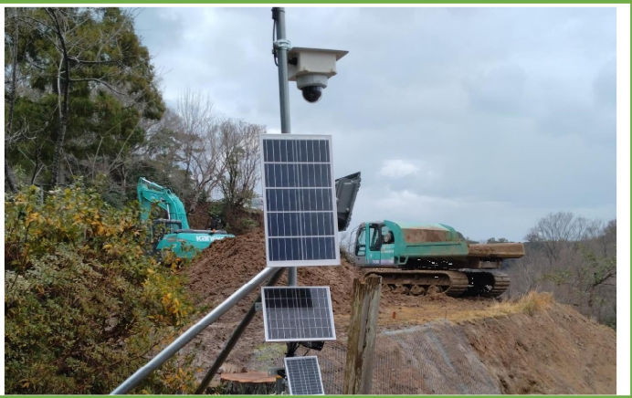
監視カメラ（PTZカメラ）設置状況
