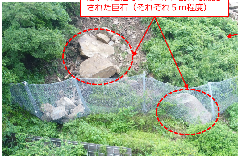
巨石を落石防護柵で捕捉 (県道への被害なし)
