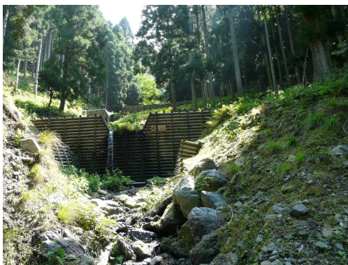
荒谷山国有林(高島市)木製床固工
